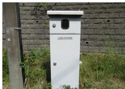
自動調光照明制御盤
