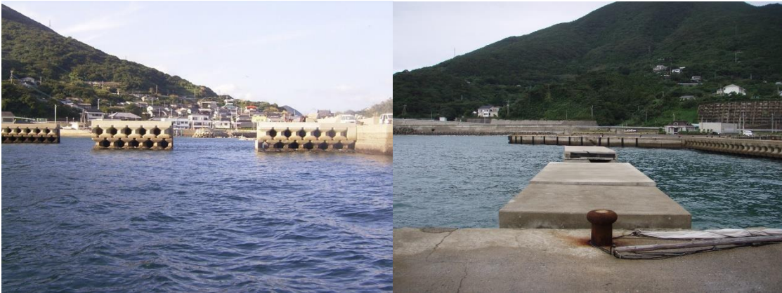
【新魚目地区立串漁港内防波堤崩落被害】
